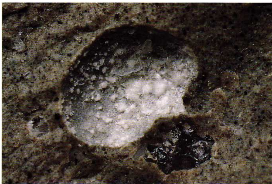
Bollosità nel cemento Portland in cui si osservano piccoli cristalli aciculari di ettringite associati a cristalli laminari di calcite. Coll. MSNM inv. M31893, foto R. Appiani.
